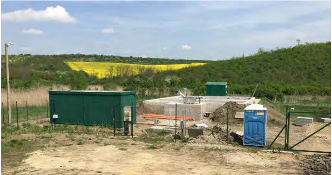
1.225 PE treatment plant, Ungarn
